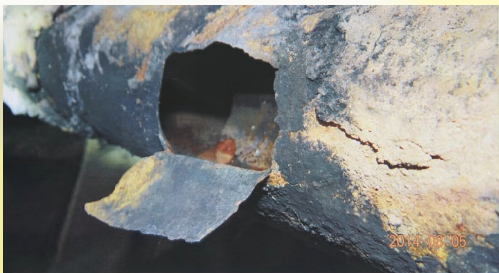
4 吋管破口管壁由內而外破裂翻出
