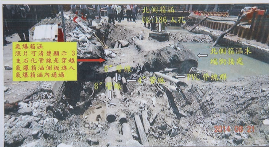
3 支石化管線(含洩漏丙烯之李長榮公司 4 吋管)穿越 氣爆箱涵(北側箱涵)之俯視照片
